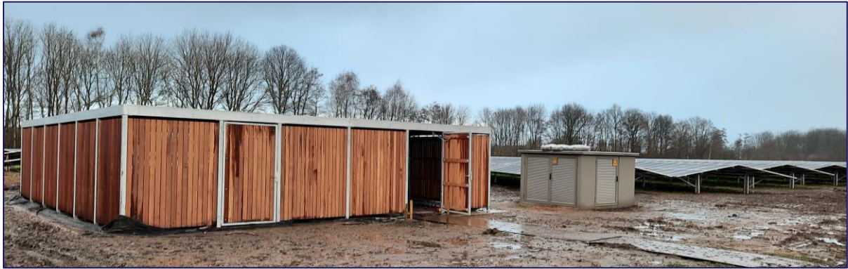
Figuur 6 | Foto van omvormersruimte bij zonnepark Wervershoof (Bron: HHNK)
