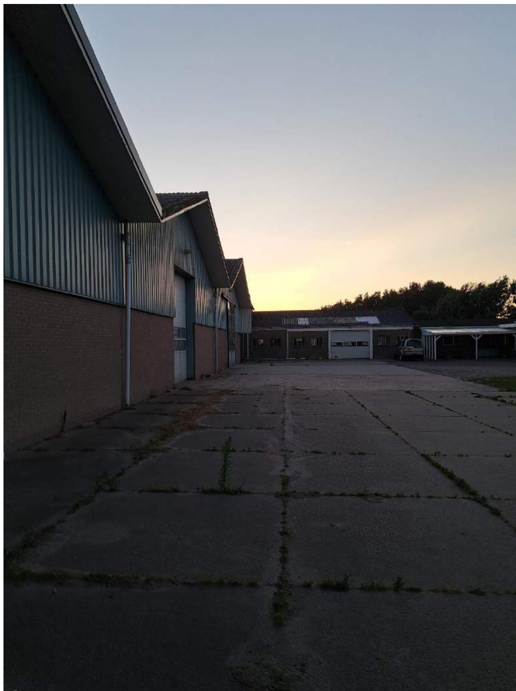
Schuren westkant plangebied geen spouwmuur aanwezig
