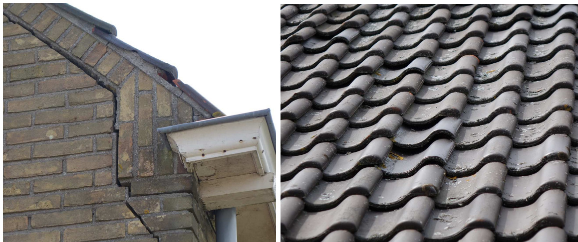
Figuur 3. Scheuren in de (spouw)muur en ruimte in het pannendak.
