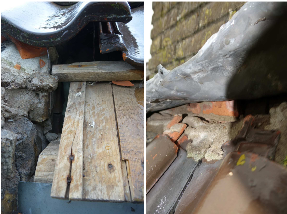
Figuur 3. Check van de spouwmuur bij de scheur aan de noordwestzijde van de woning (links) en de loodslabben onder de schoorsteen (rechts).
