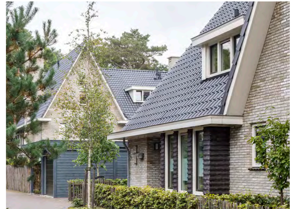
Nokverdraaiing, bij een twee-onder-één-kap woning
