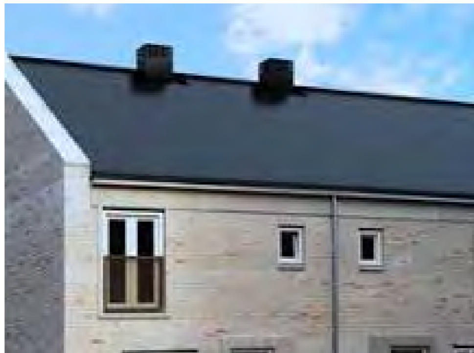
Luchtwarmtepompen pijpen in één schoorsteen
