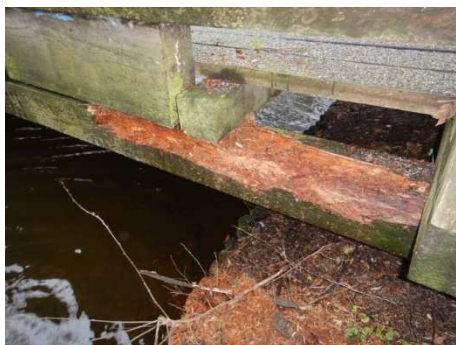
Figuur 4: Schade aan brug B64
